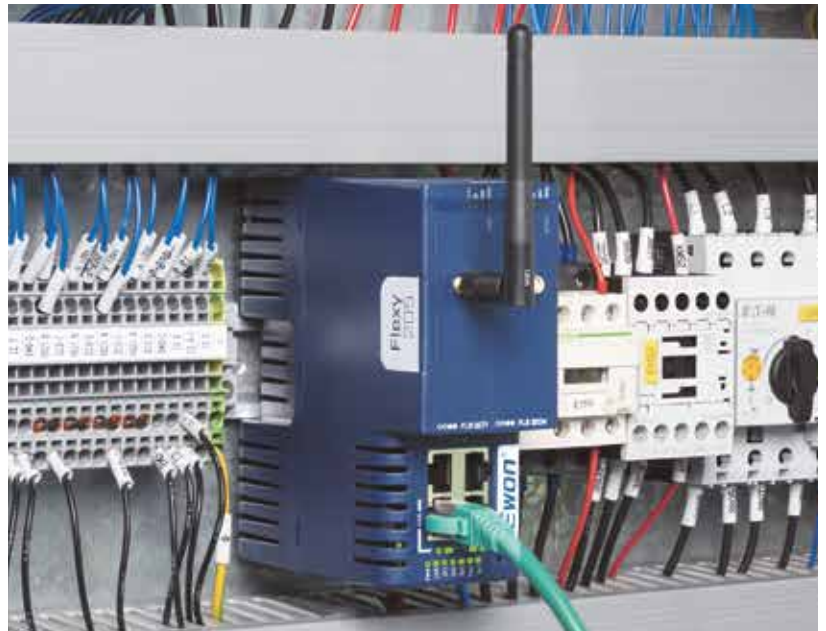
Il router compatto è collocato nell'armadio elettrico della macchina
